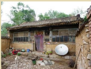
屋面明显塌陷
