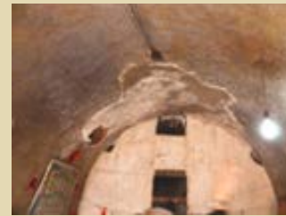
窑顶潮湿渗水
