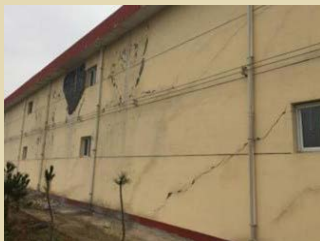
房屋墙体出现不均匀沉降裂缝
