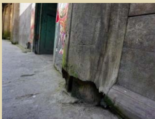
木柱柱脚糟朽
