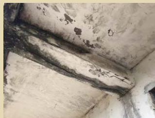
混凝土挑梁裂缝
