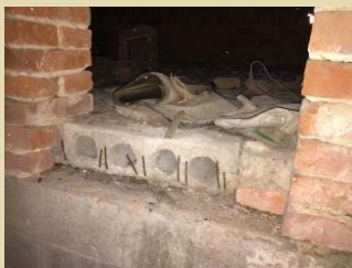
预制板屋盖无拉结措施
