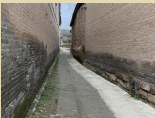
房屋周边排水不畅
