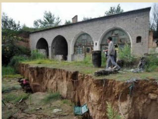
地基局部坍塌
